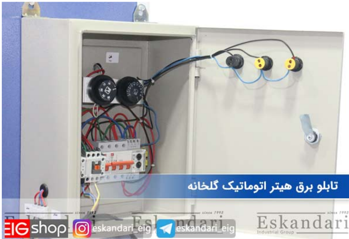
تابلو برق هیتر اتوماتیک گلخانه
